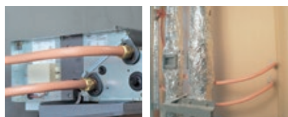
ファンコイルユニット接続配管 パイプシャフト内の接続配管
