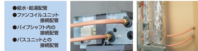
ファンコイルユニット接続配管 パイプシャフト内の接続配管
